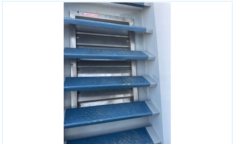
Brandkleppen onder trap. (ook achterzijde woning)
